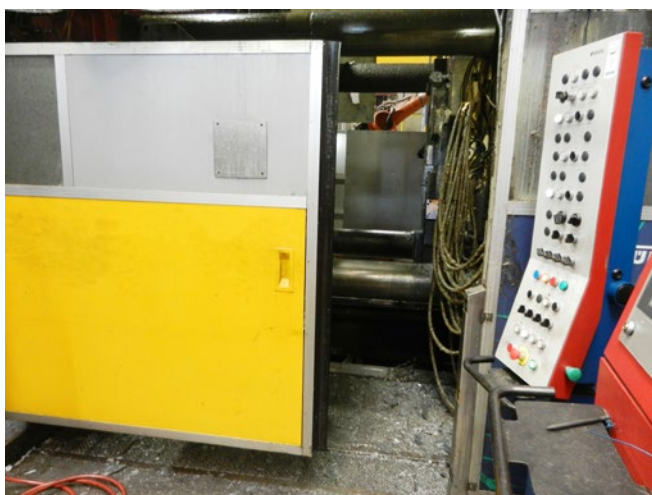
Abb. 21 Schutztür mit Schließkantensicherung
