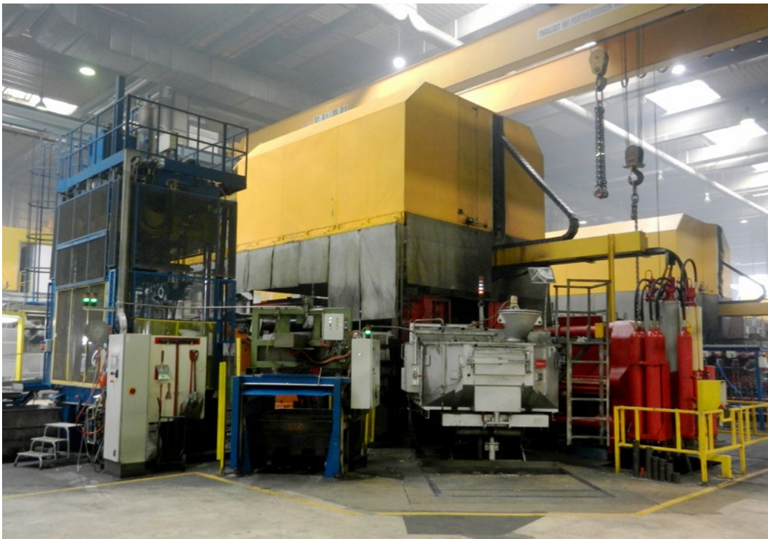
Abb. 20 Teilansicht einer Druckgießanlage
