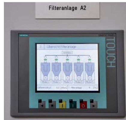
Bild 5: Die Bedienung und Visualisierung der Filteranlagen erfolgt über Touch Panels.
