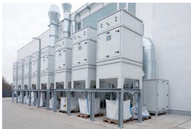
Bild 3: Acht Absaug- und Filteranlagen vom Typ ZPF sind platzsparend außerhalb der Halle errichtet.
