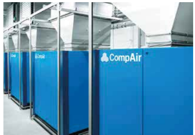
Bild 4: Die sechs CompAir-Schraubenkompressoren vom Typ L250 im Borbet-Werk Kodersdorf. Mit einer Gesamtantriebsleistung von 1500 kW arbeiten sie sehr energiesparend.
