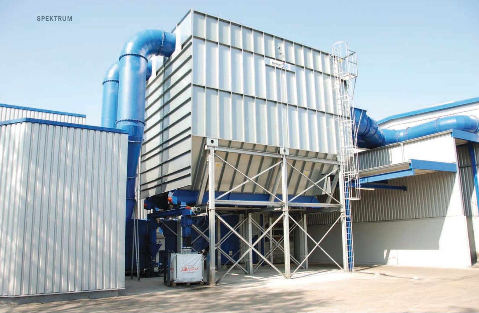
Niederdruckspülluft- anlage in der Jürgens Gießerei in Emsdetten.
