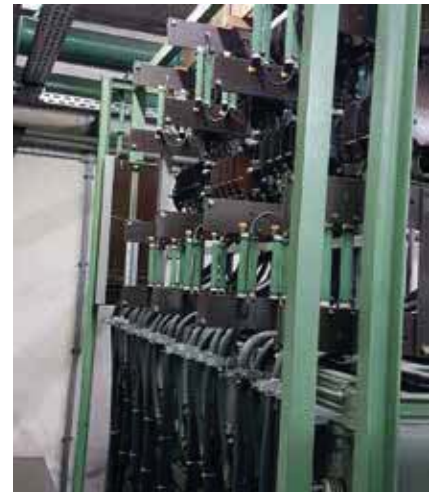
Bild 2: Kondensatorbatterie vor dem Umbau.
